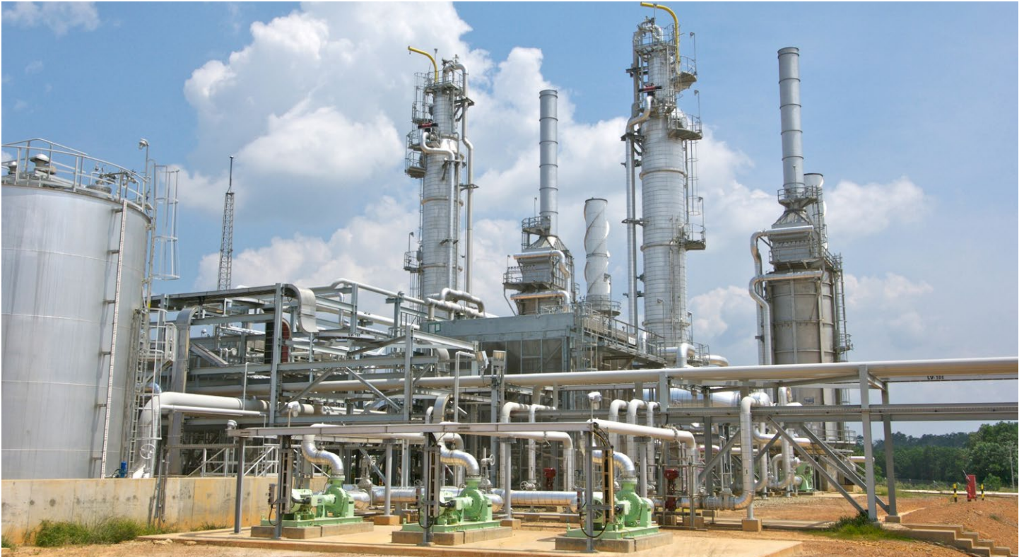
Suban Gas Plant.
